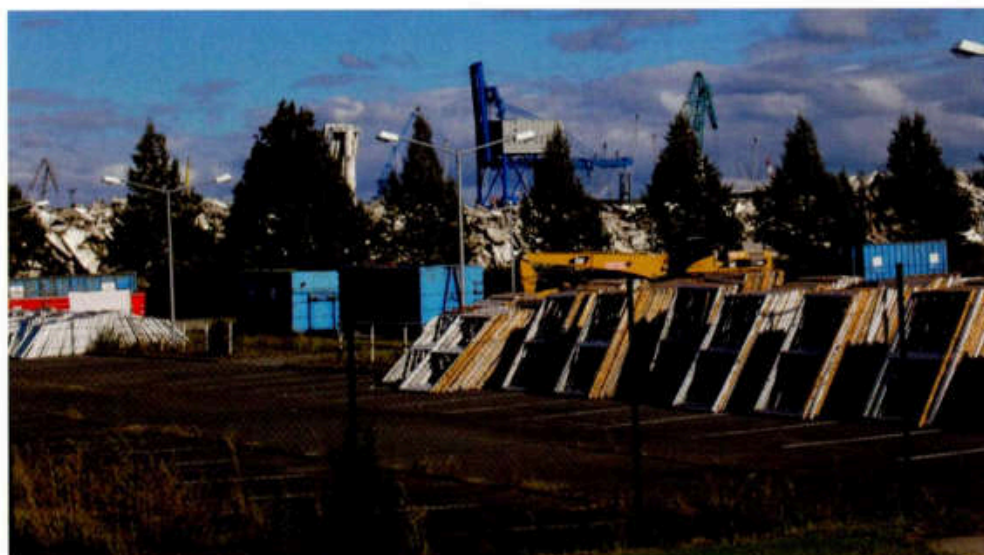
Die Reste des DSR-Gebäudes im Überseehafen Rostock
