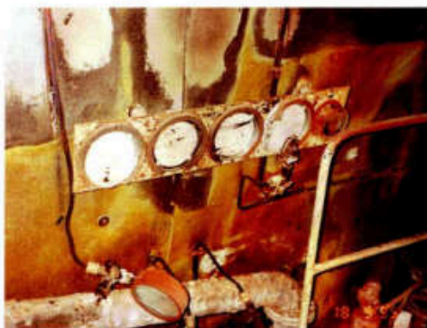
Nach dem Brand im Maschinenraum des MS BRANDENBURG (18.05.1995) Verglühte Metallteile des Abgaskessels (Foto oben), die Zylinderkopfstation (Foto Mitte) und ausgeglühte Armaturen des Abgaskessels (Foto links)
