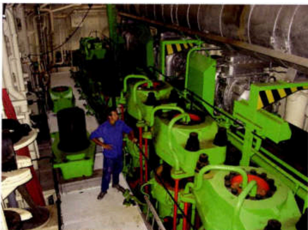
Hauptmotor, Station obere Abgasschieber Zylinder 1 bis 8
