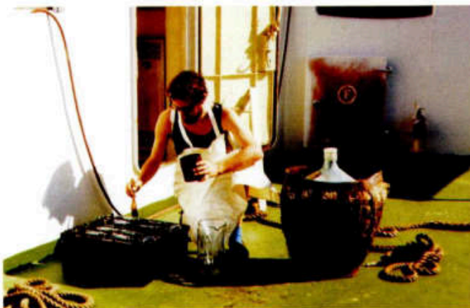
Funkoffizier Friedrich Seibicke bei der Wartung der Notsenderbatterien
